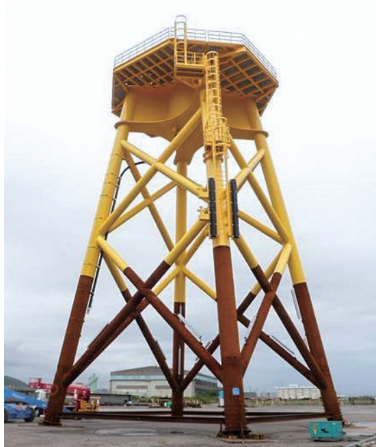
図1 洋上風力発電設備のジャケット式基礎(写真) Fig.1 Jacket Foundation for Offshore Wind Turbine (Photo)
