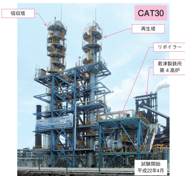
図2 試験プラント(CAT30)の外観 Fig. 2 Overview of test equipment (CAT30)
