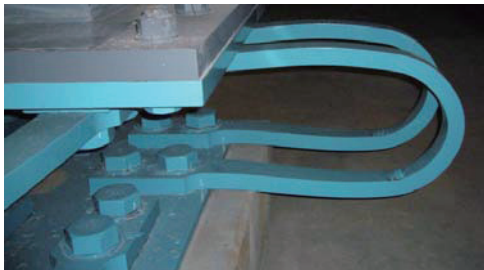
(a)震災後の変形状況
