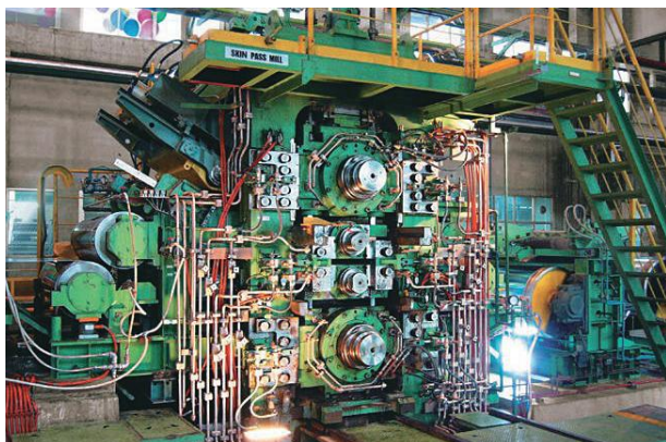
図6 鋼板処理設備におけるスキンパスミル
