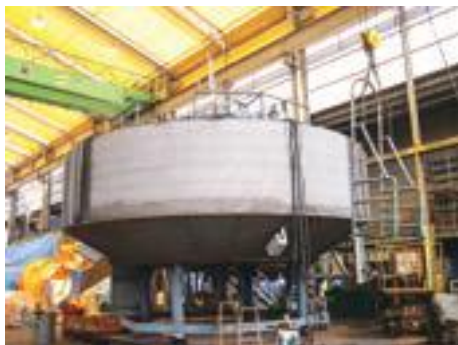
図5 防食用ステンレス(浮体舷側)
