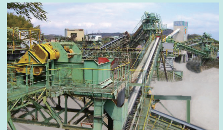
汚染土壌洗浄プラント
