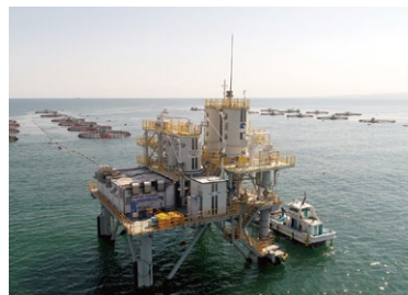
自動給餌設備システム(鳥取県境港市)
