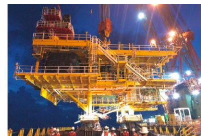
タイ湾アーティット鉱区/海洋天然ガス生産設備新設
