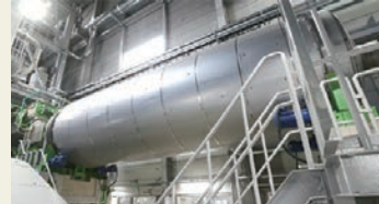
福岡市/西部水処理センター
