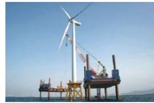
洋上風力発電施設
