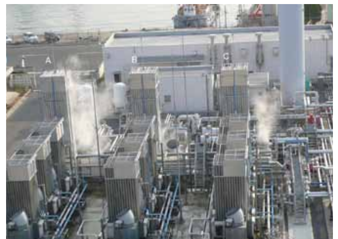
図 11 Site Y における冷気排気ファン併用時の消霧状況 (Case2)
