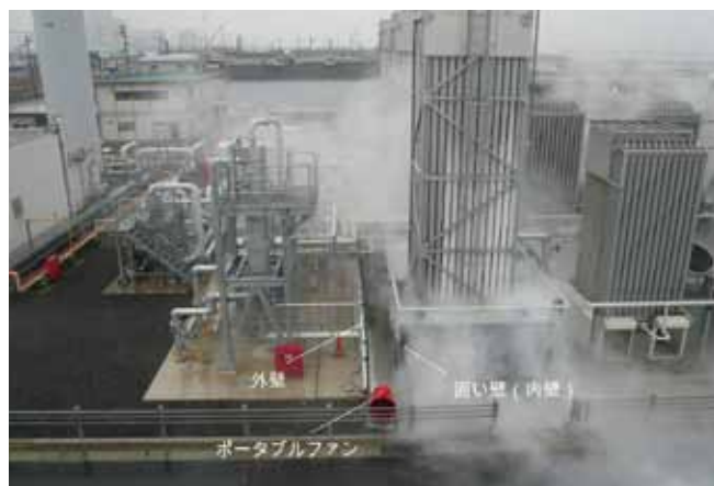
図13 二重壁間への送風による消霧状況 Fig.13 Defogging by doubly walled air fin vaporizer
