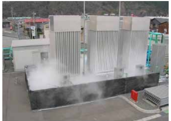
図4 SiteX における囲い壁を設置した空温式気化器の消霧状況 Fig.4 Defogging by walled air fin LNG vaporizer at Site X
