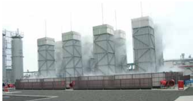
図 18 Site Z における消霧状況 Fig.18 Defogging by doubly walled air fin LNG vaporizer at site Z
