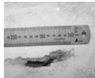
写真2 検出した塗覆装損傷例 Photo.2 Coating defect (example)
