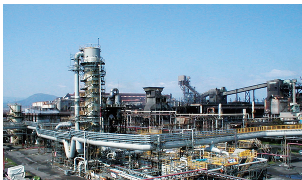
写真1 大分製鉄所殿向け タール・安水分離装置(右手前)と冷却装置(左) Overview of COG Cooling System
