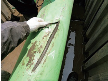
写真1 塗覆装の損傷例
