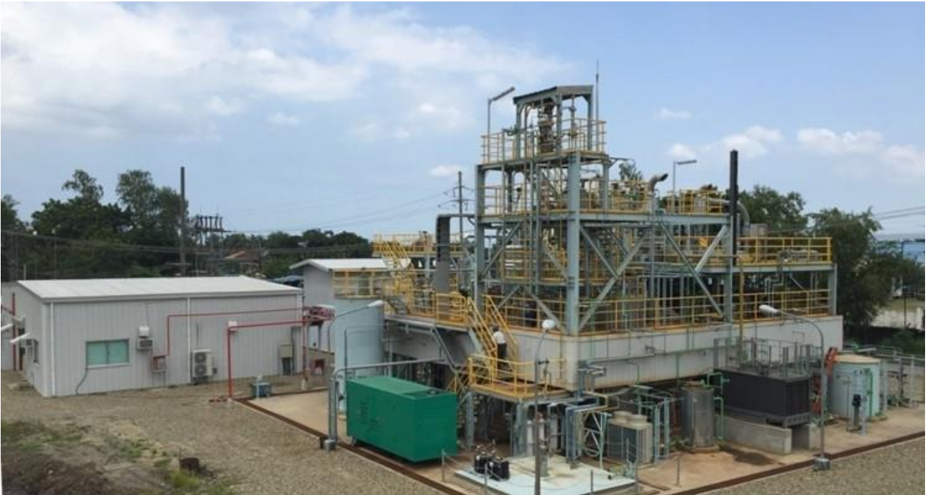
【セルロース系バイオエタノール製造設備（パイロットプラント）】
