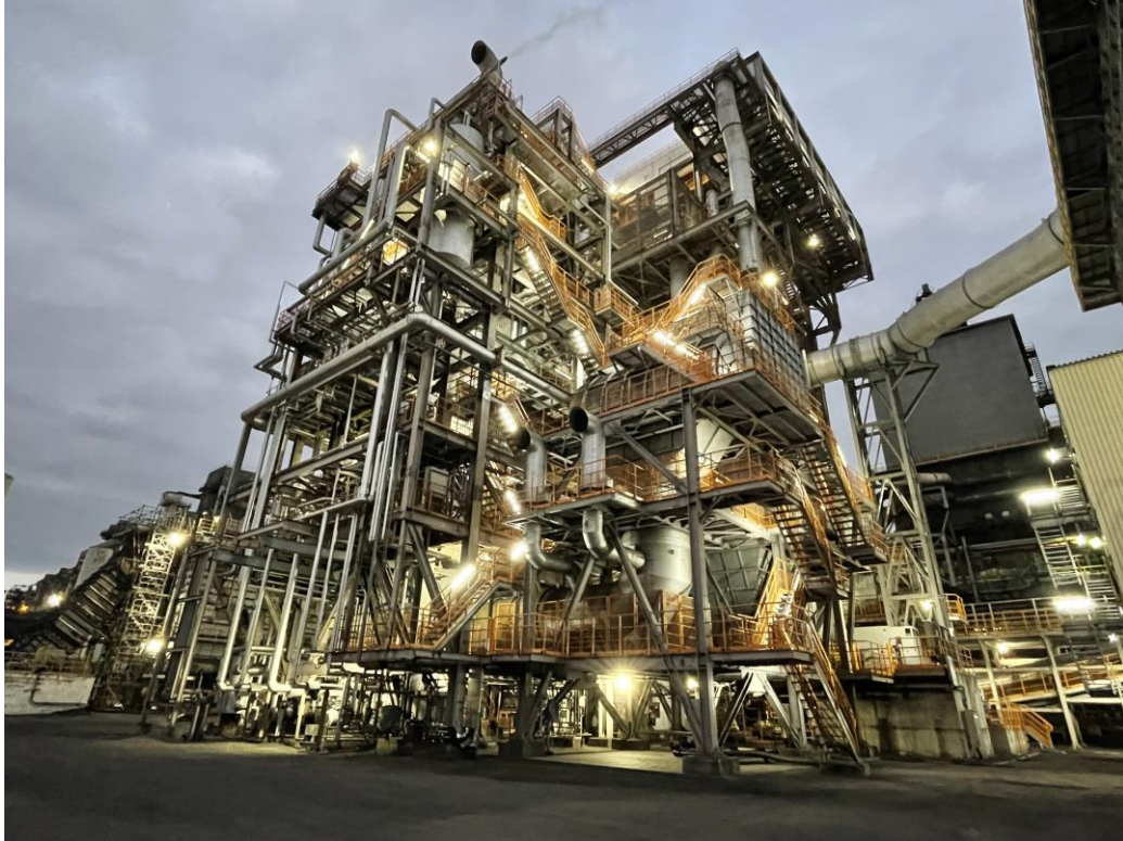
【JFE スチール(株) 東日本製鉄所 千葉地区 No.3 CDQ 設備外観】
