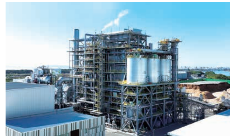
広畑バイオマス発電所
