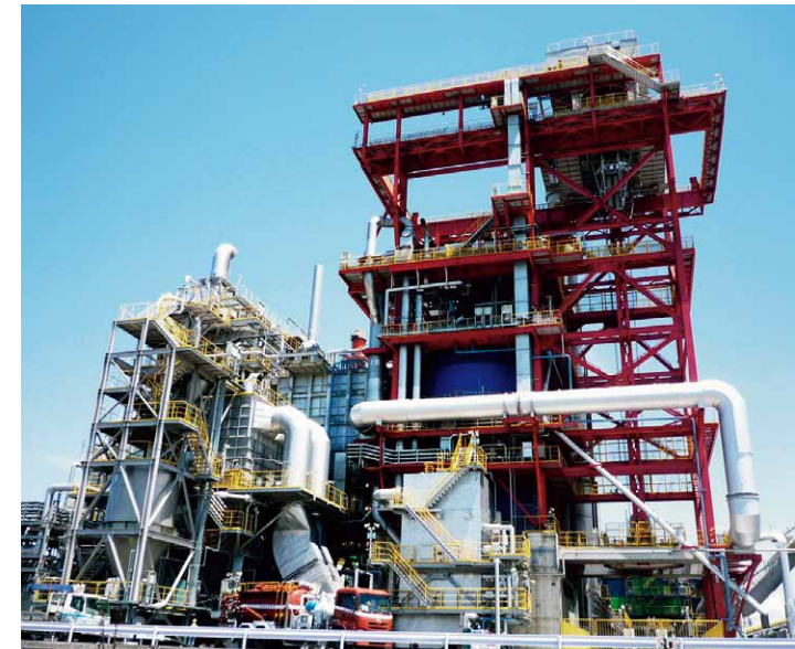
■ コークス乾式消火設備(CDQ)
