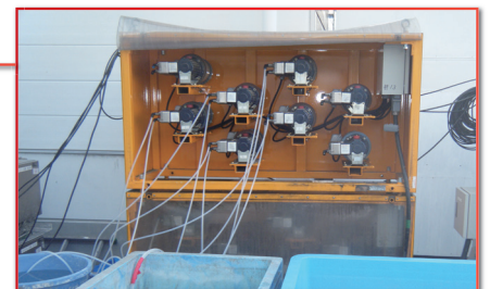
注入プラント
