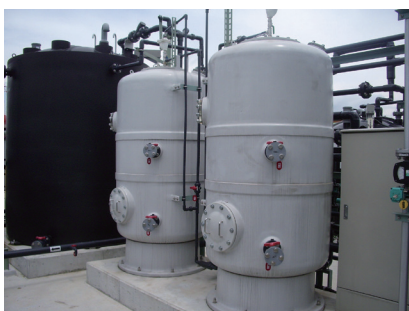
重金属吸着塔
