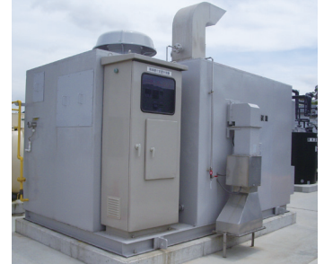
ガス処理装置(触媒酸化装置)
