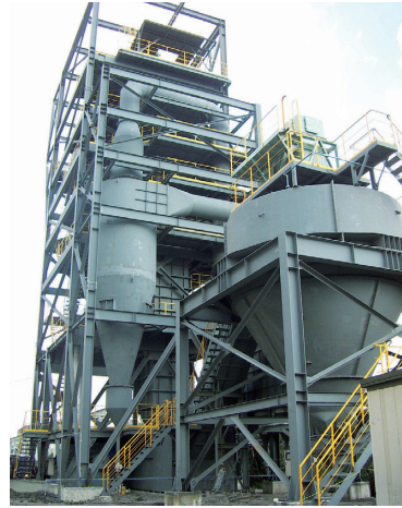
写真1 フルスケール実験機外観
