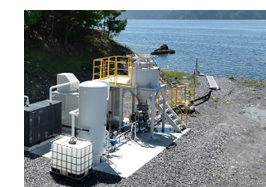
自動給餌設備（岩手県釜石市）
