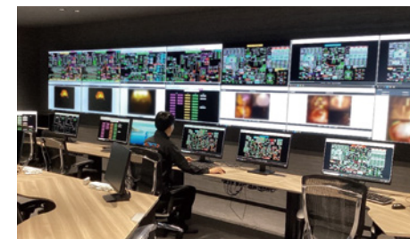
Think Operation Center®は、遠隔支援とデータ分析を通じて、プラントの安全・安定操業を支え、継続的な進化を後押しする中核拠点。
