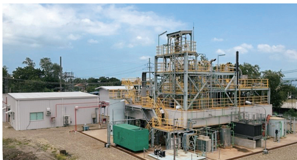
図4 実証設備(写真) Fig. 4 Pilot plant(photo)
