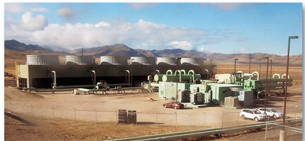
図5 超臨界サイクル バイナリー地熱発電設備(TAS社実績)の外観
