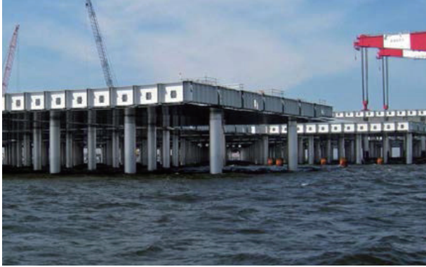
写真1 SUS被覆を適用した海洋鋼構造物 Photo. 1 Offshore structure using metallic sheathing corrosion protection technique
