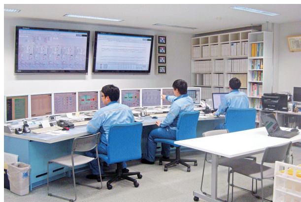
図3 日鉄住金エネルギーサービス(株) エネルギーセンター中央監視室
