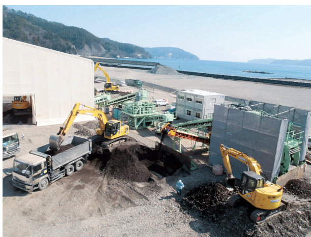
図6 稼働中のプラント全景
