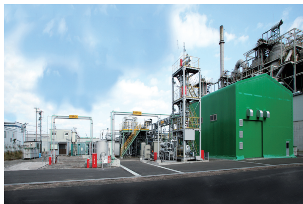
写真1 食品廃棄物エタノール化パイロットプラント Photo. 1 The ethanol pilot Plant from food waste
