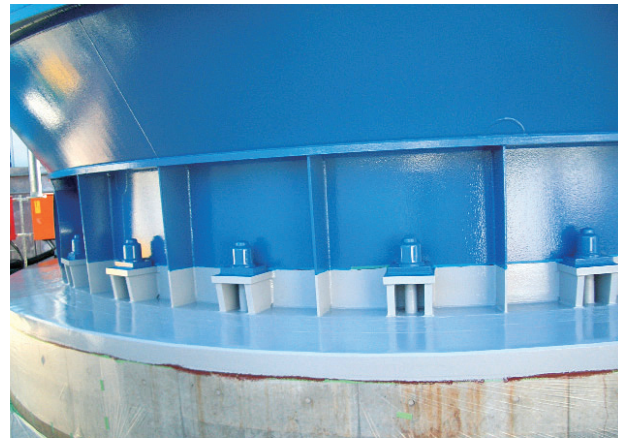
写真2 分割構造とした支持構造部外観 Photo. 2 Outside view of divided support structure
