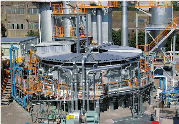
図2 朝日工業殿向け RHF 設備外観 Fig. 2 RHF plant in Asahi Industries
