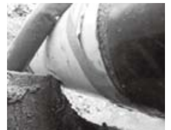
写真 4 メタルタッチ例 Photo.4 Contact with pipeline (example)
