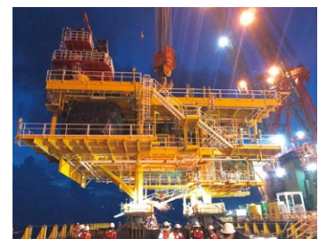
タイ湾アーティット鉱区/海洋天然ガス生産設備新設
