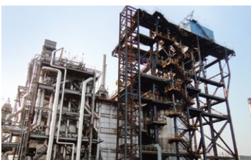
コークス乾式消火設備(CDQ®)
