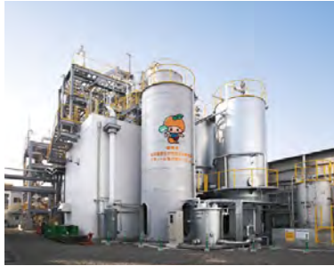
ミカンジュースの製造工場内に設置されたバイオエタノールの実証プラント
