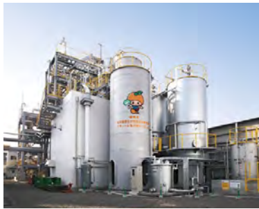
ミカンジュースの製造工場内に設置されたバイオエタノールの実証プラント
