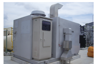
ガス処理装置(触媒酸化装置)
