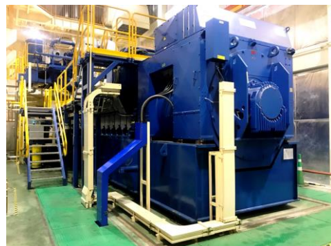
【ガスエンジン】
