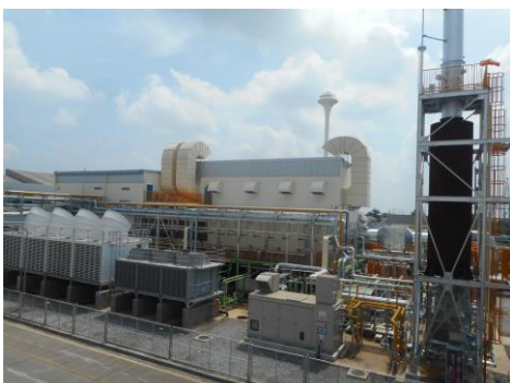
【コージェネレーション設備外観】
