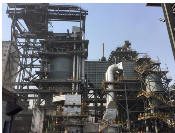
【第1期拡張工事におけるCDQ】
