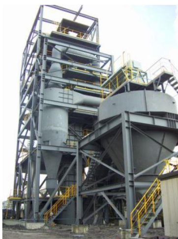
【写真】 フルスケール実験機外観
