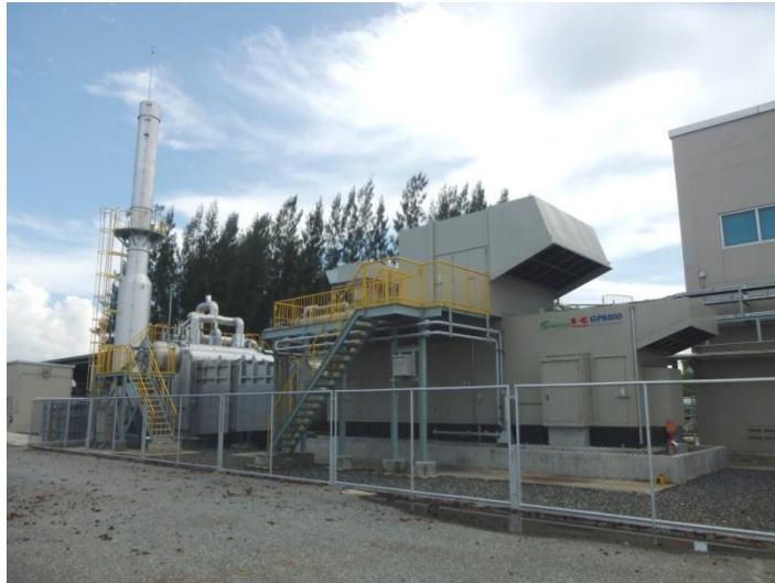
YTMT 社 コージェネレーション設備
