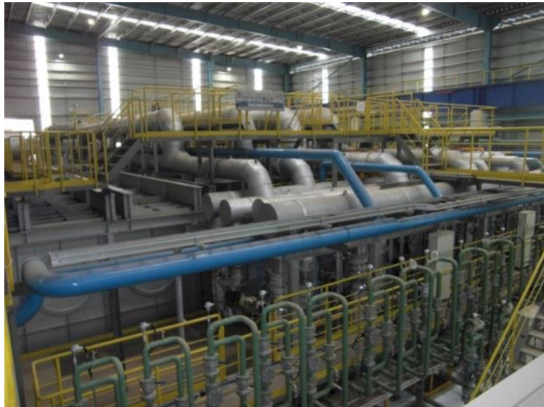
【加熱炉全景写真】
