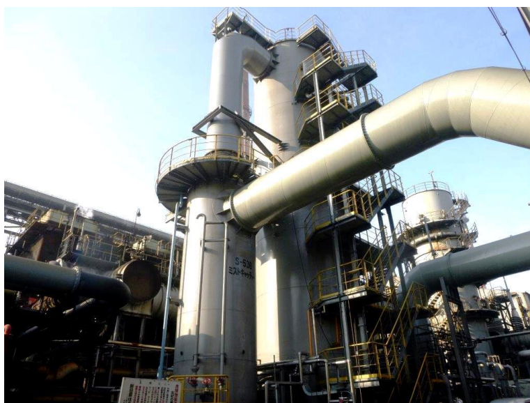
【新日鉄住金(株)君津製鐵所/化成 COG ファイナルクーラー設備（全景）】
