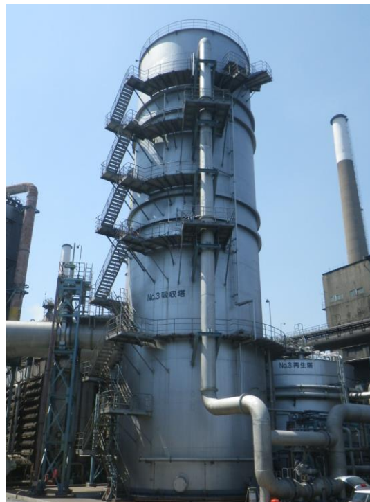
【エア・ウォーター㈱ケミカル部門鹿島工場向け/化成 COG 脱硫設備（全景）】
