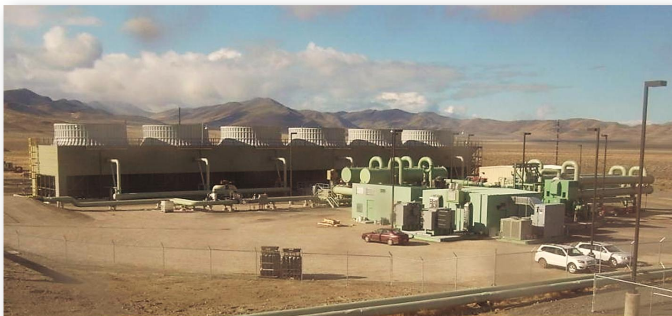
【タス社製バイナリー発電装置外観】
