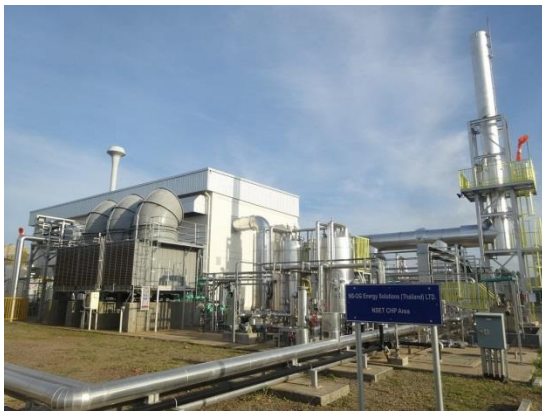
コージェネレーション設備外観
