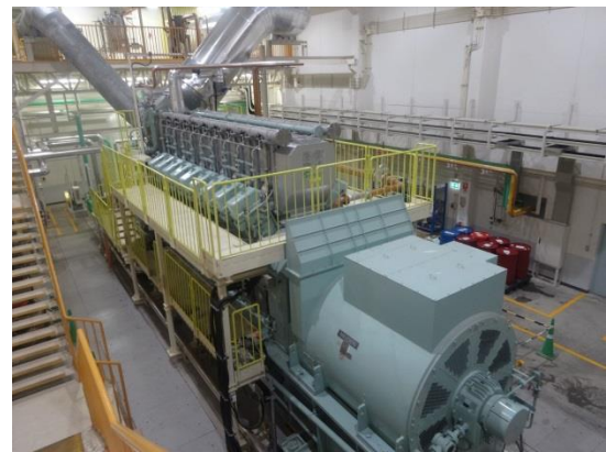
ガスエンジン
