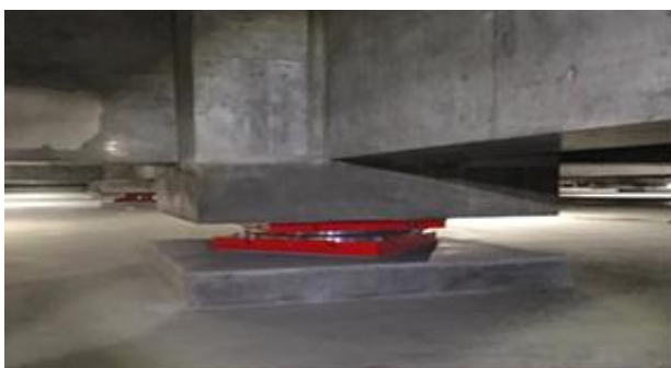
NS-SSB設置状況（免震層）
